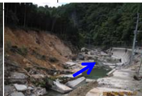
星野川に沿った土砂崩れ、道路決壊(星野村古野)
