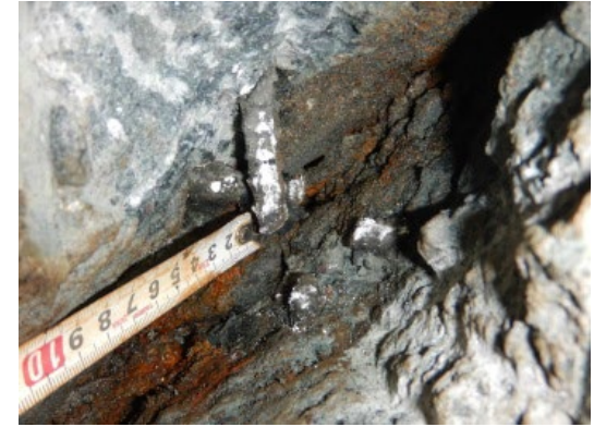
函体鉄筋の露出と破断
