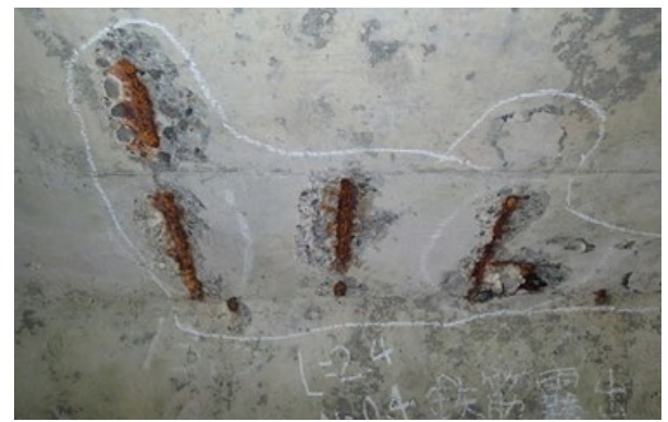
鉄筋の露出と腐食
