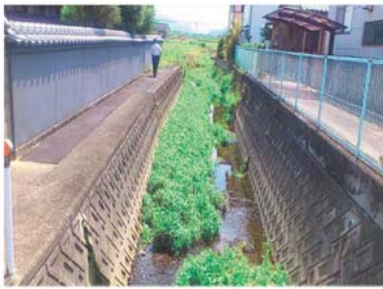
川西地区を流れる県管理小河川の古子川 (勾配に対して垂直方向に流れるなど無理がある)
