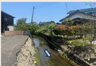
護岸の損傷～蛸島川～
