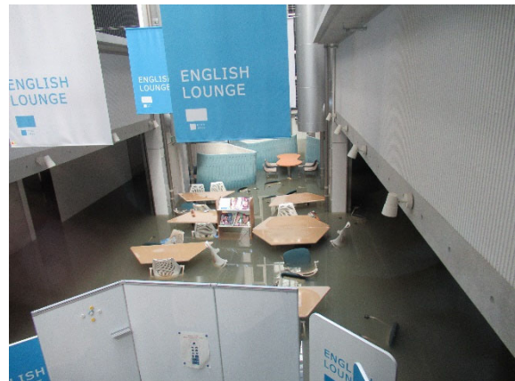
1号館地下浸水状況
