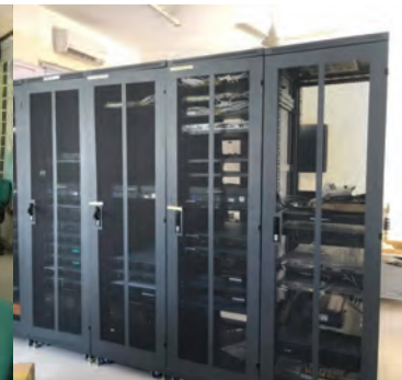
サーバールーム
