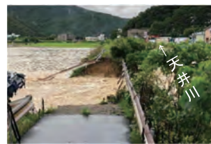
沼田川水系天井川の堤防決壊 (広島県三原市)
