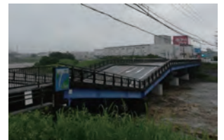
黄瀬川大橋の被害状況 (静岡県沼津市)
