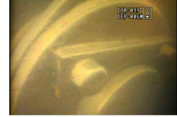
取水ゲート設備
