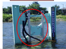
主・副水位計ケーブルが保護管から外れている
