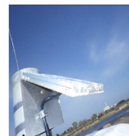
汚れた太陽電池
